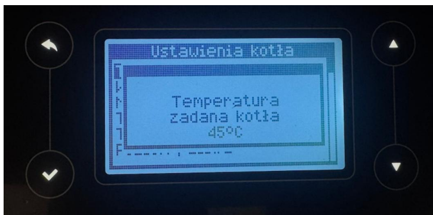
Rys. 5-3:2 Widok ustawienia temperatury zadanej kotła
